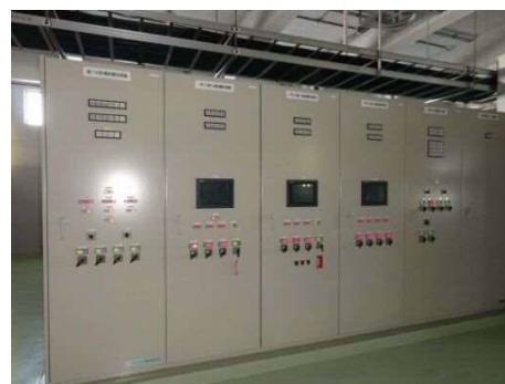
(電気計装設備)
